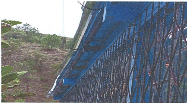
Foto 3: Sustrucción de canales y bajantes
