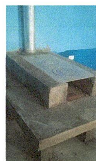
Foto 6: Sustrución de estufa rural completa
