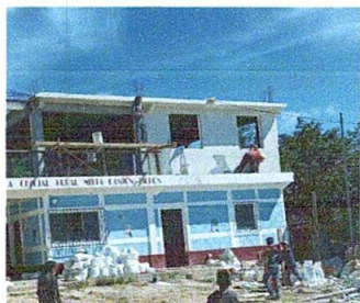
Foto 1: Repello aulas segundo nivel
