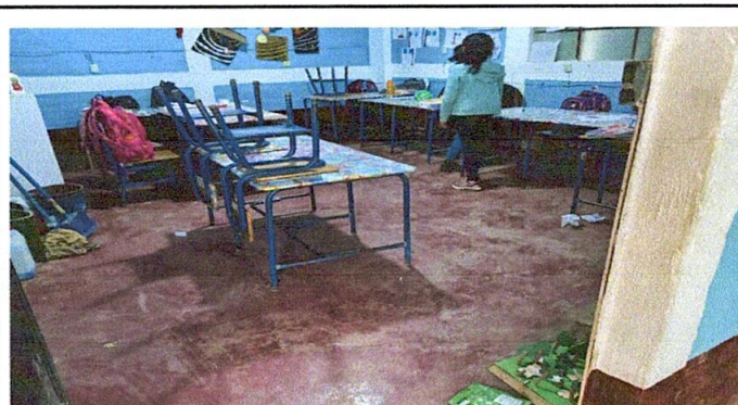
Foto 4: piso del aula No. 2 del primer nivel
