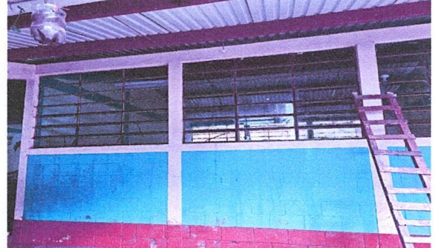
Foto 8: Se necesita sustitucion de varios vidrios de ventanas quebrados desde hace tiempo
