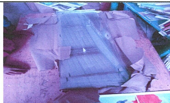
Foto 8: Se necesita sustitucion de varios vidrios de ventanas quebrados desde hace tiempo
