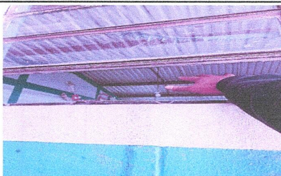
Foto 8: Se necesita sustitucion de varios vidrios de ventanas quebrados desde hace tiempo
