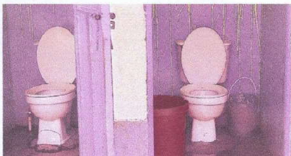
Foto 7: Servicios sanitarios y sus accesorios.
