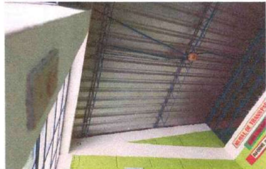
Foto 4: Ducto electrico y accesorios para direccion
