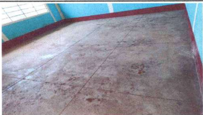
Foto 1: Torta de cemento por piso granito aula 1
