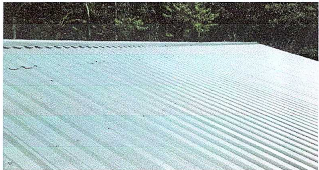
Foto1: Láminas y capotes en malas condiciones instaladas
