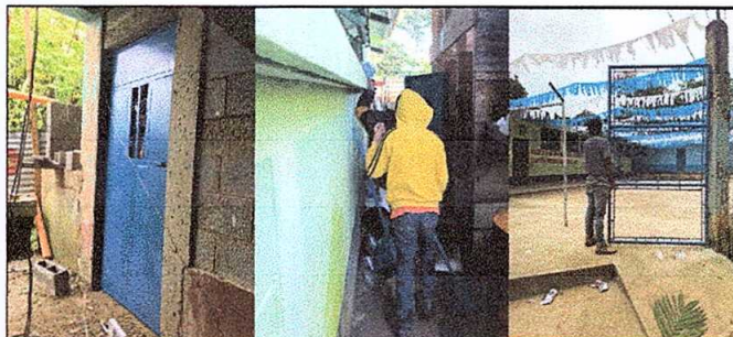
Foto 4: Colocación de puertas para aulas, cocina, baños y portón en malas condiciones.
