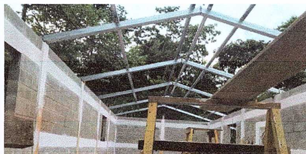
Foto 2: Instalación de estructura de techo en mal estado
