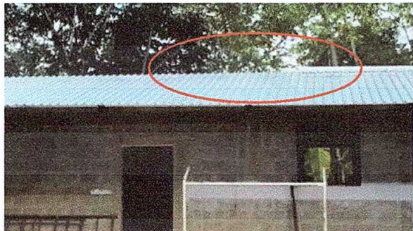
Foto1: Instalación de láminas y capotes en malas condiciones
