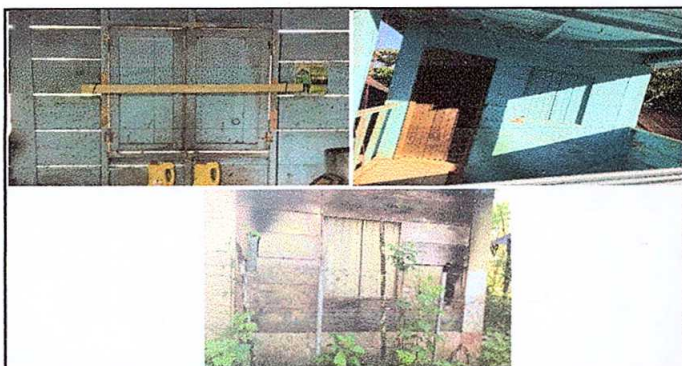
Foto 5: Ventanas de cocina y aulas en mal estado.
