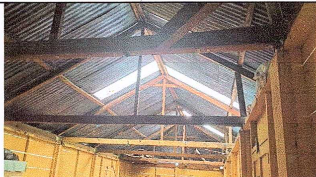
Foto 2: Estructura de techo en mal estado
