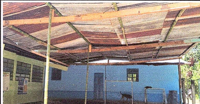
Foto 2: Estructura de techo en mal estado
