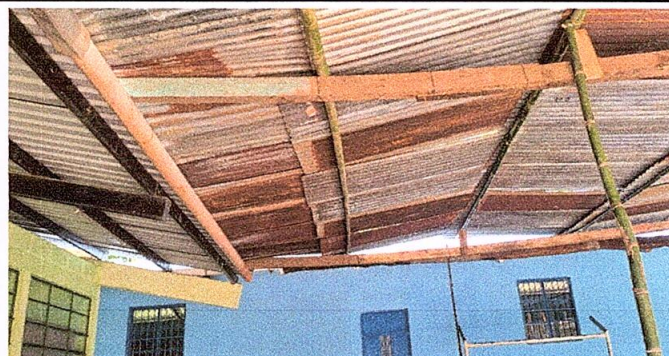
Foto 4: Canales en malas condiciones
