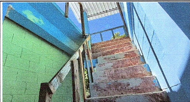
Foto 5: Barandas en condiciones deficientes
