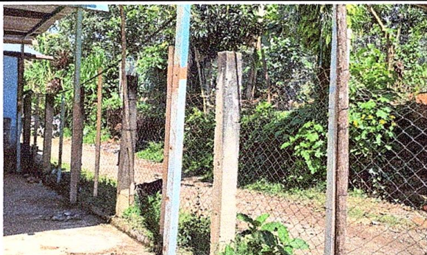
Foto 3: Perímetro con malla y madera en malas condiciones
