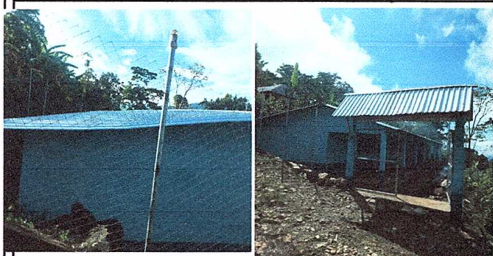
Foto1: Lámina en malas condiciones Estructura de techo
