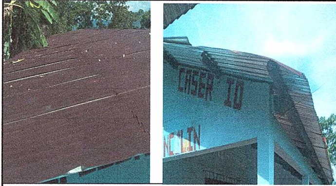
Foto1: Lámina en malas condiciones Estructura de techo
