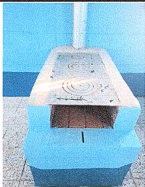
Foto 7: Plancha en malas condiciones
