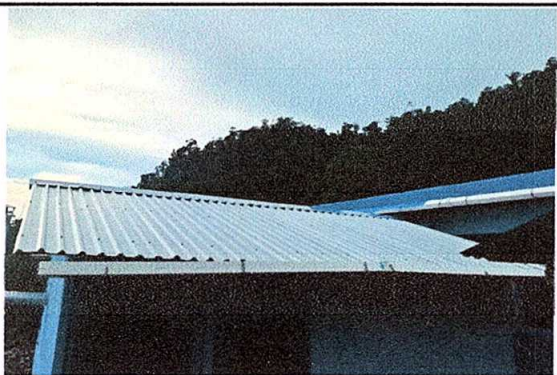
Foto 1: Lámina en malas condiciones
