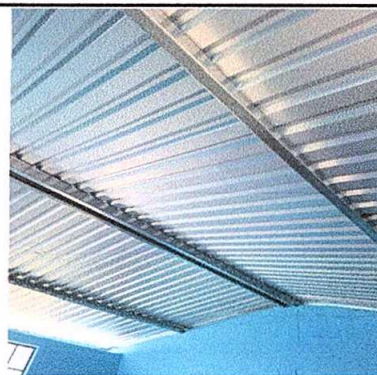
Foto 2: Madera del techo en malas condiciones
