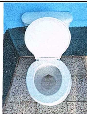
Foto 10: Inodoros en mal estado
