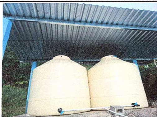
Foto 9: Rotoplas en mal estado
