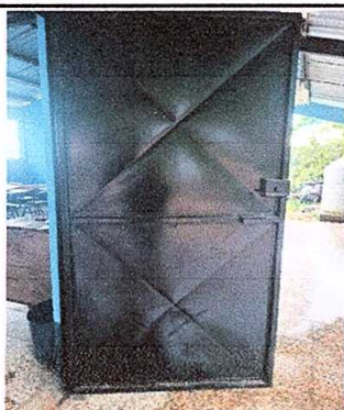
Foto 3: Pintura de puerta deteriorada
