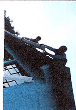
Foto 6: Canales en mal estado
