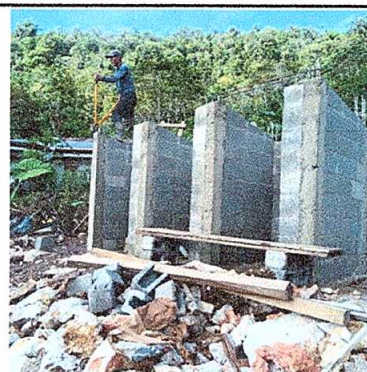
Foto 10: Inodoros en mal estado
