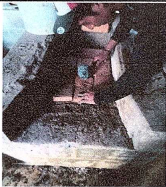
Foto 7: Plancha en malas condiciones
