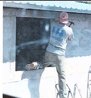
Foto 4: Ventanas en mal estado
