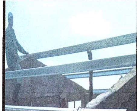
Foto 2: Madera del techo en malas condiciones
