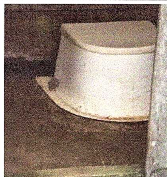
Foto 10: Inodoros en mal estado
