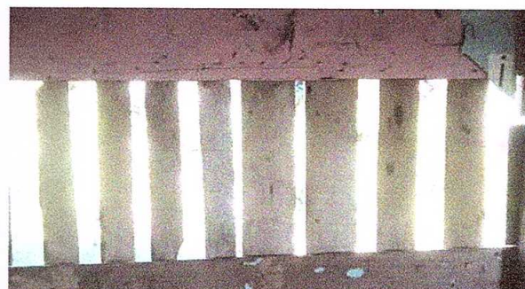
Foto 4: ventanas en mal estado
