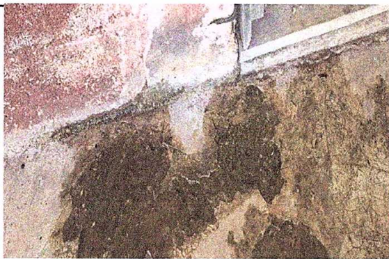
Foto 5: Piso en mal estado
