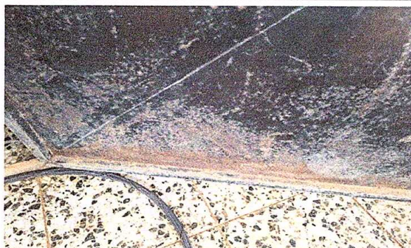
Foto 3: Pintura de puerta deteriorada
