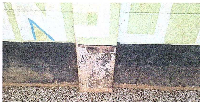
Foto 8: Pintura en mal estado
