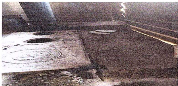
Foto7: Plancha en malas condiciones
