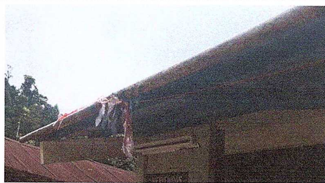
Foto 6: Canales en mal estado
