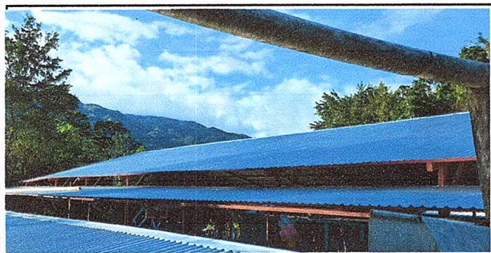
Foto 5: lamina, elementos de fijación y capotes en mal estado
