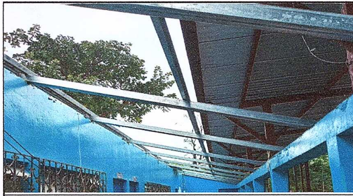
Foto 2: Estructura de madera en malas condiciones
