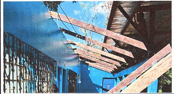
Foto 2: Estructura de madera en malas condiciones
