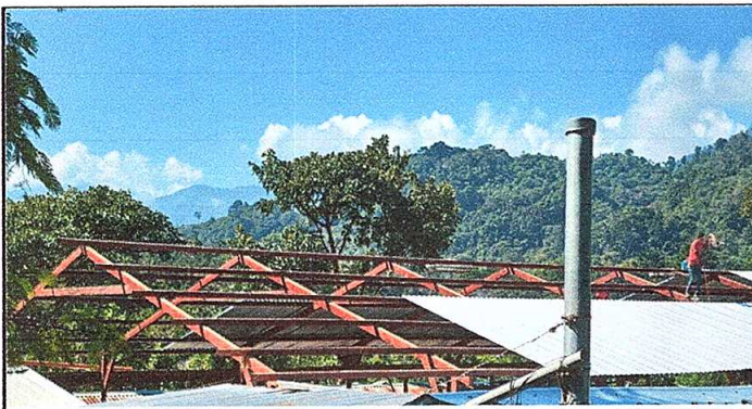
Foto 3: lamina, elementos de fijación y capotes en mal estado
