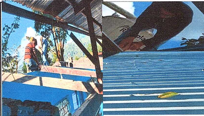
Foto 1: lamina, elementos de fijación y capotes en mal estado
