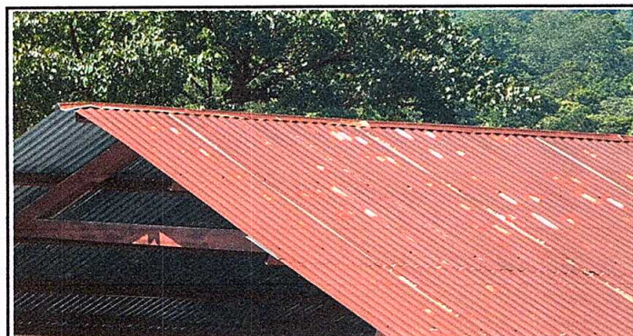
Foto 3: lamina, elementos de fijación y capotes en mal estado
