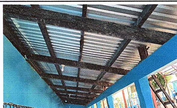
Foto 2: Estructura de madera en malas condiciones
