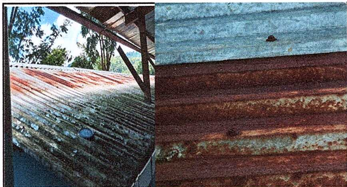
Foto1: lamina, elementos de fijación y capotes en mal estado
