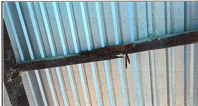
Foto 4: Estructura de madera en malas condiciones
