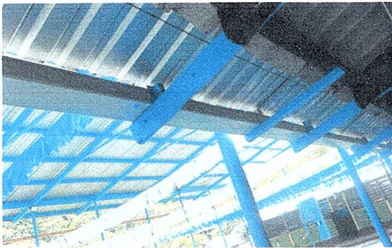
Foto 3: Canaletas en mal estado.
