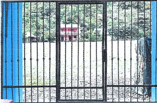
Foto 1: Portón en malas condiciones.
