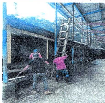
Foto 4: Tubo PVC y tubo galvanizado en malas condiciones.
