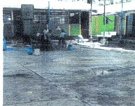
Foto 2: Cancha deteriorada y en malas condiciones.
