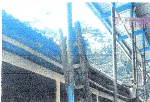
Foto 3: Canaletas en mal estado.
