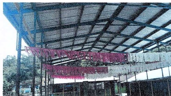
Foto 4: Tuvo PVC y tubo galvanizado en malas condiciones.
