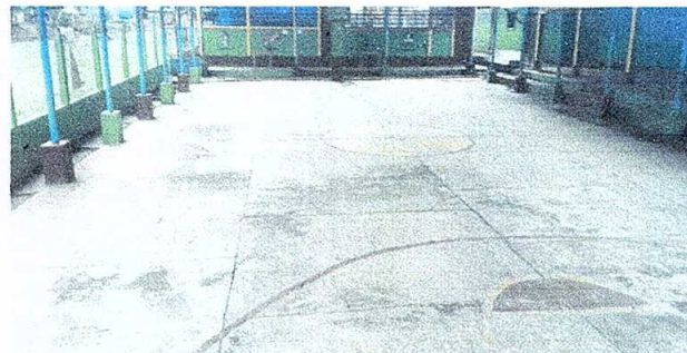
Foto 2: Cancha deteriorada y en malas condiciones
