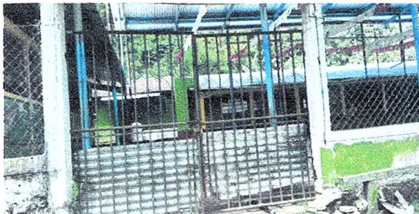
Foto1: Pórtón en malas condiciones
