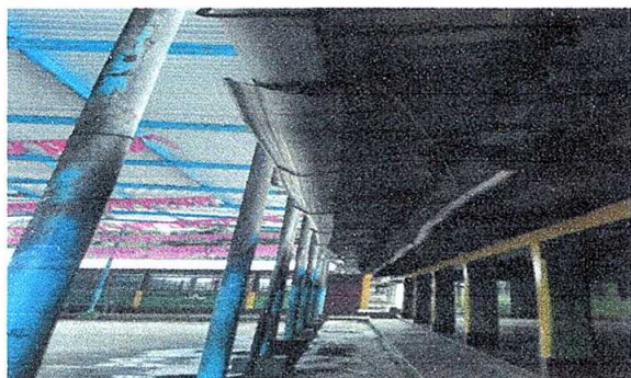
Foto 3: Canaletas en mal estado
