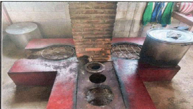
Foto 3: sustitución de parrillas y plancha
