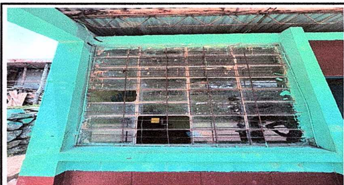
Foto 4: sustrucción de una ventana de 3 mts alto x 1.7 mts ancho en la dirección
