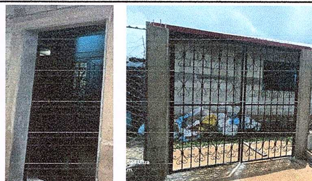
FOTO No. 4: Sustrucción de puerta (2.01m de alto * 0.95m de ancho)
