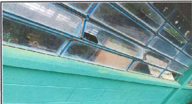
Foto 9: Sustrucción de vidrios
