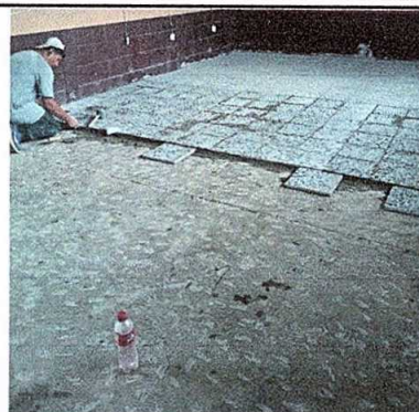
Foto 2: Sustrucción de piso, por piso de granito en mal estado.
