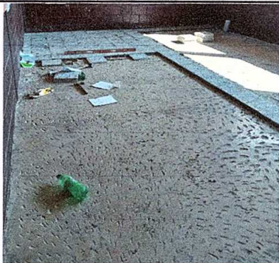
Foto 1: Sustrucción de piso, por piso de granito en mal estado.
