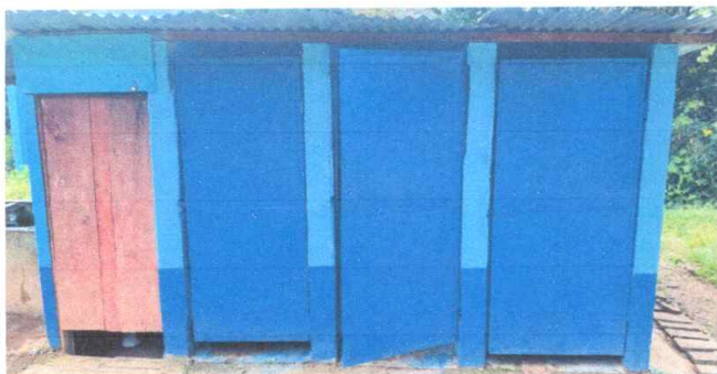
Foto 03: PUERTAS DE METAL
