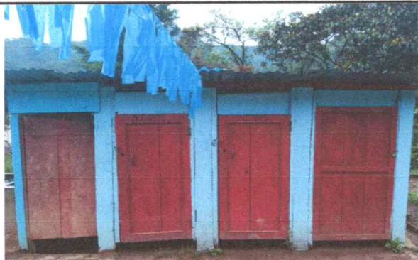
Foto 03: PUERTAS DE METAL
