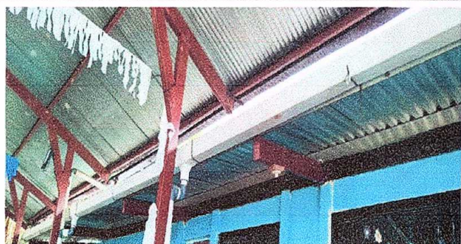
Foto 5: Canales de pvc en mal estado.
