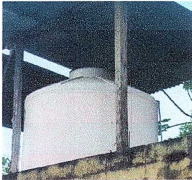
Foto 13: Depósito de agua con fuga y en mal estado.
