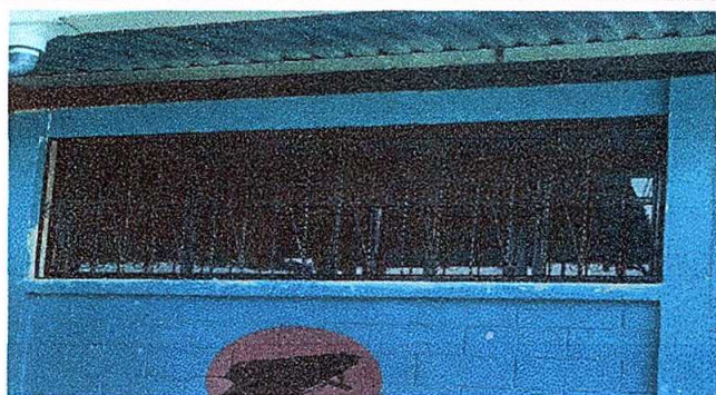
Foto 3: Sustrucción de ventanas en aulas
