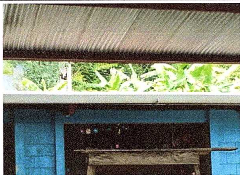
Foto 5: Canales de PVC en mal estado.
