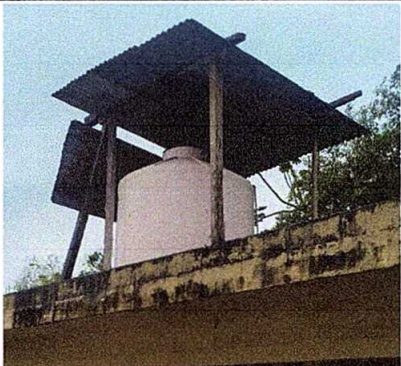
Foto 13: Depósito de agua con fuga en mal estado.
