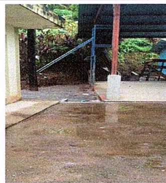
Foto 14: Torta de concreto de grietas en mal estado.
