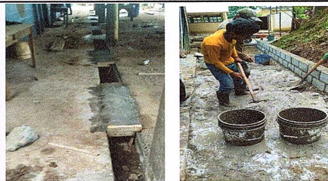
Foto 6: Cunetas de la escuela en mal estado y que provocan propagacion de mosquitos.
