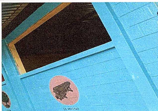
Foto 3: Ventanas en mal estado. Aulas
