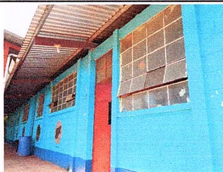
Foto 2: Ventanas en mal estado. Dirección.
