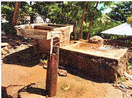
Foto 11: Pila de la cocina en mal estado.
