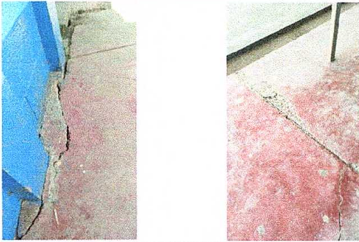
Foto7: Banquetas de la escuela rajadas y en mal estado.
