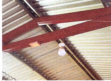
Foto 8: Focos y cables en mal estado en las aulas.
