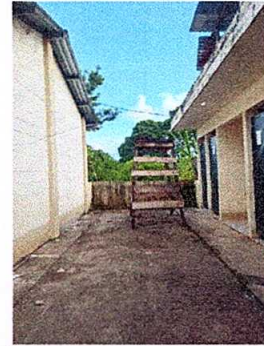
Foto 14: Torta de concreto con grietas y en mal estado.
