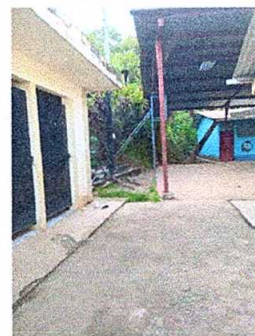
Foto 12: Losa de concreto del patio en mal estado.
