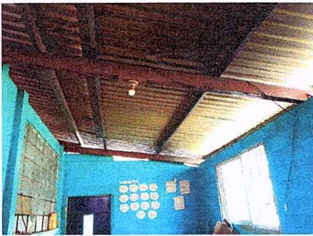
Foto 9: Focos y cables en mal estado en la cocina.
