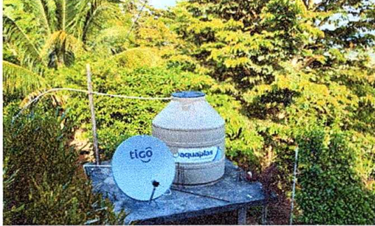
Foto 13: Depósito de agua con fuga y en mal estado.
