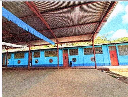
Foto 4: balcones de metal en ventas de las aulas.
