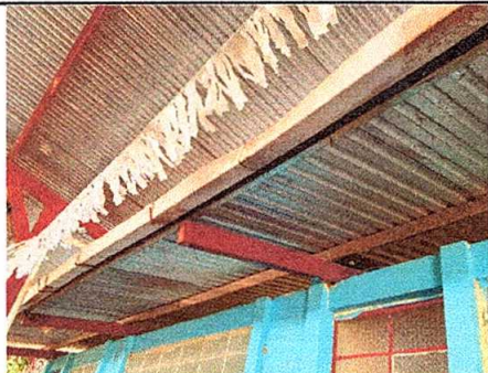
Foto 5: Canales de PVC en mal estado.
