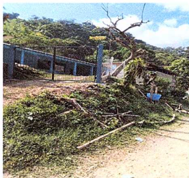
Foto 4: Portón en malas condiciones
