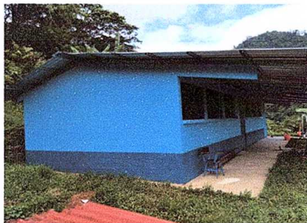
Foto 6: Pinturas en malas condiciones
