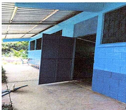
Foto 3: Puerta en malas condiciones
