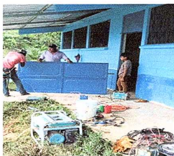
Foto 3: Puerta en malas condiciones
