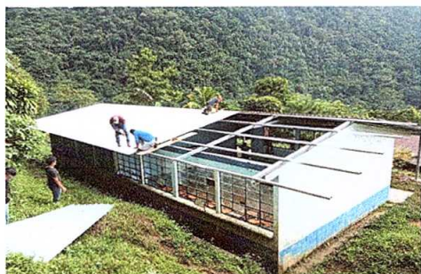
Foto 1: Lámina en malas condiciones
