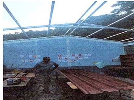
Foto 2: Estructura del techo en malas condiciones
