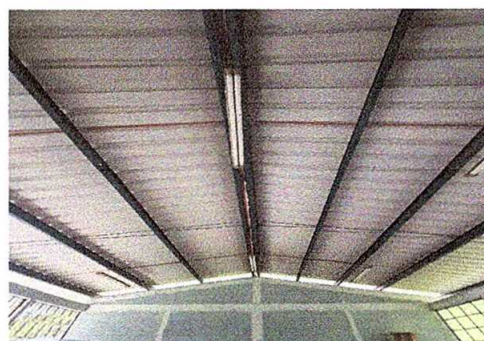
Foto 2: Estructura del techo en malas condiciones
