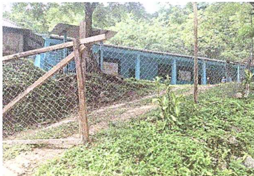
Foto1: Circulación en malas condiciones
