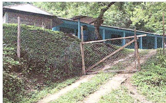
Foto 4: Portón en malas condiciones
