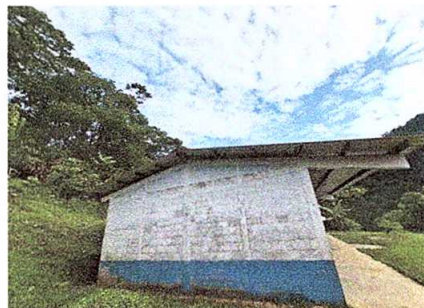
Foto 6: Pinturas en malas condiciones
