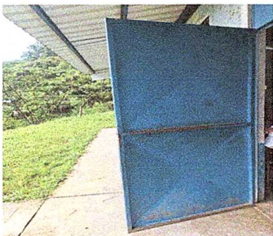
Foto 3: Puerta en malas condiciones
