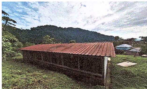
Foto 1: Lámina en malas condiciones
