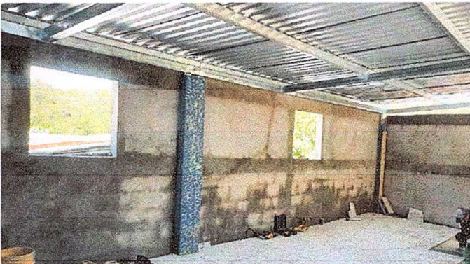
foto 10: ventanas de PVC
