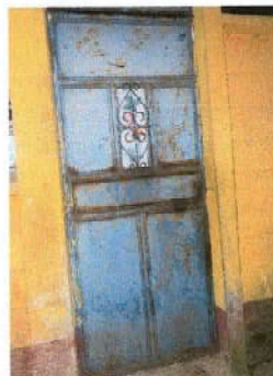
Foto 4: Sustitución de puerta de aula en mal estado
