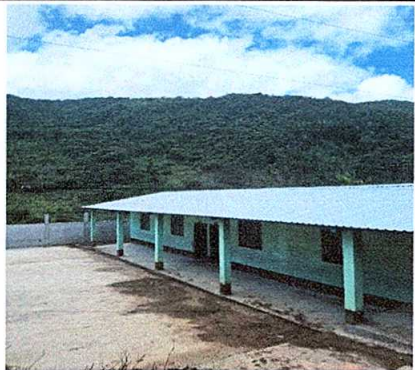
Foto 1: Lámina en malas condiciones
