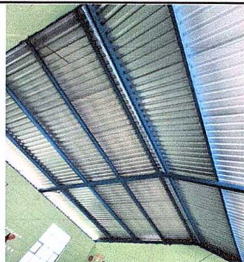
Foto 2: Pintura de estructura deteriorada
