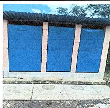
Foto 4: Puertas de baño en mal estado
