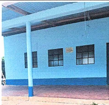
Foto 3: Pintura de paredes deteriorada
