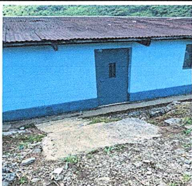
Foto 3: Puertas de aulas deteriorada
