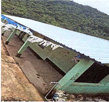
Foto7: Piso en malas condiciones.
