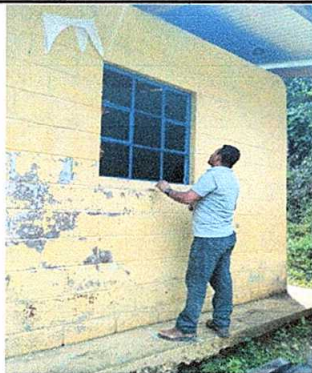
Foto1: Ventana en malas condiciones
