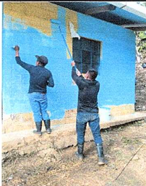
Foto 3: Pintura de paredes deteriorada
