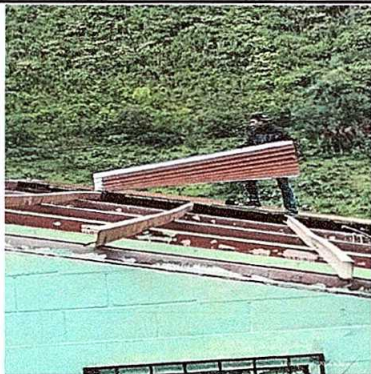
Foto1: Lámina en malas condiciones
