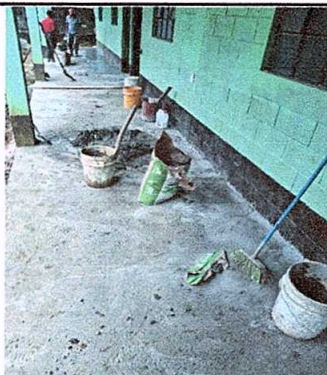
Foto7: Piso en malas condiciones.
