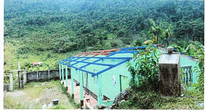
Foto 2: Pintura de estructura deteriorada
