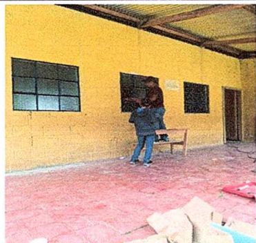
Foto 5: Ventanas de metal y vidrios en malas condiciones
