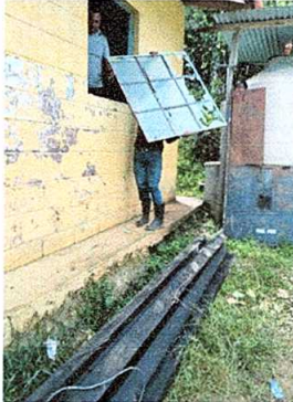
Foto1: Ventana en malas condiciones
