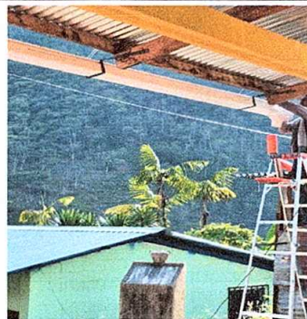
Foto 6: Canales, bajantes y pescantes en malas condiciones
