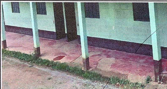
Foto7: Piso en malas condiciones.
