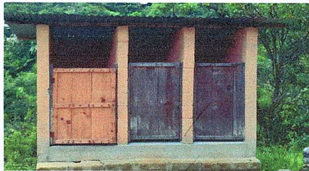
Foto 4: Puertas de baño en mal estado
