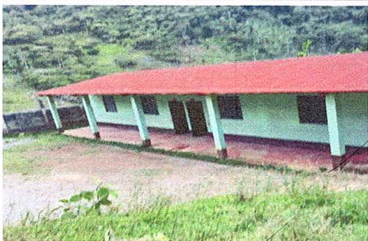
Foto 1: Lámina en malas condiciones
