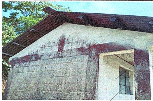
Foto 2: Soportes de madera en mal estado
