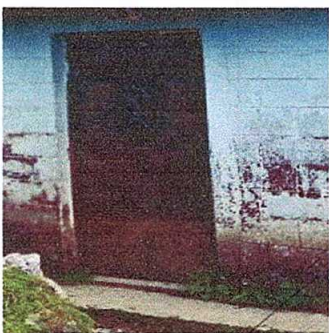
Foto 3: Puertas de aulas deteriorada
