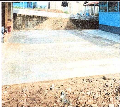
Foto 1: Sustrucción de piso de torta de concreto.
