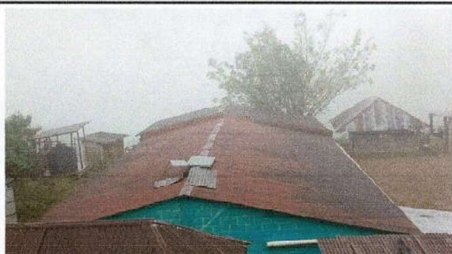
Foto 1: Sustrucción de lámina en malas condiciones por lámina troquelada
