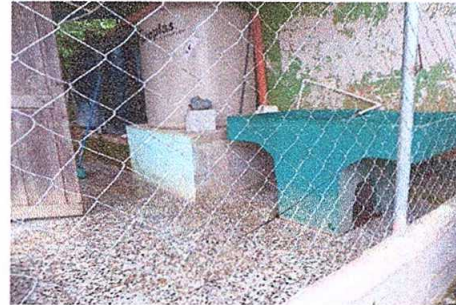
Foto 2: pila en mal estado y colocación de piso
