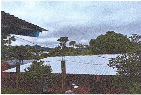
Foto 1: Lámina del salón en malas condiciones
