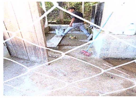
Foto 2: pila en mal estado y colocación de piso
