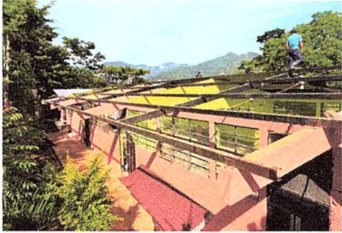
Foto 1: Lámina del salón en malas condiciones
