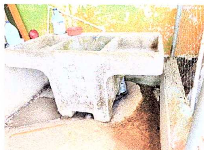
Foto 2: pila en mal estado y colocación de piso
