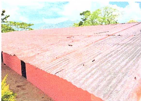
Foto1: Lámina del salón en malas condiciones
