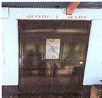
Foto 7: puerta en mal estado
