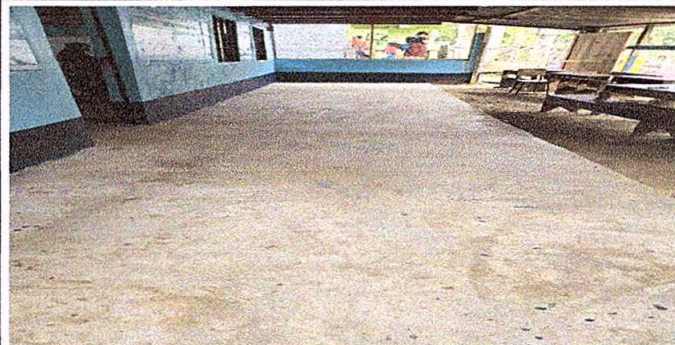
Foto 2: piso en mal estado
