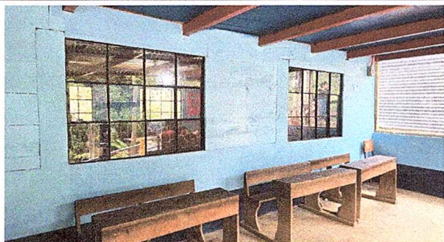
Foto1: Ventanas en mal estado
