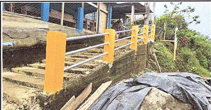
Foto 9: barandales en mal estado
