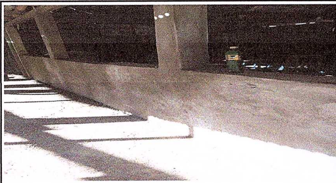
Foto1: Ventanas en mal estado
