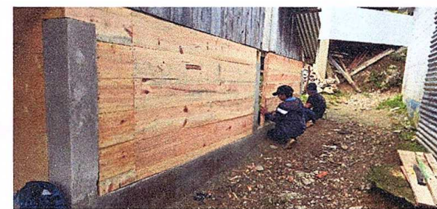
Foto 11: pared en malas condiciones
