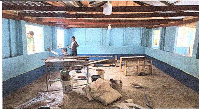
Foto 2: piso en mal estado
