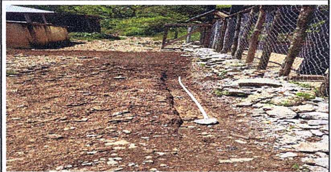
Foto 8: tubería de agua en mal estado
