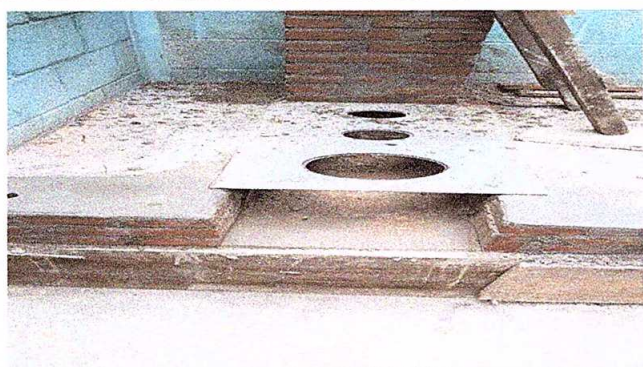
Foto 3: chimenea y plancha en malas condiciones
