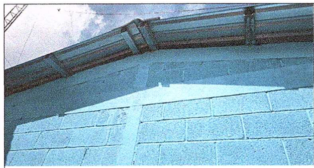
Foto 5: lamina en malas condiciones
