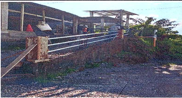
Foto 9: barandales en mal estado
