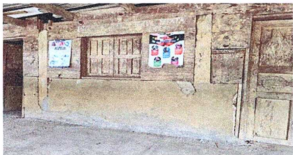
Foto1: Ventanas en mal estado
