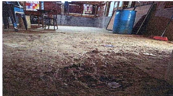
Foto 2: piso en mal estado
