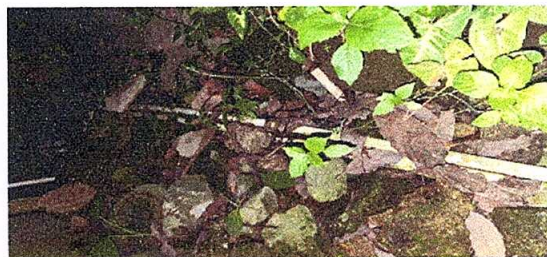
Foto 8: tubería de agua en mal estado
