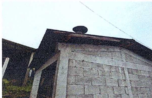
Foto 5: lámina en malas condiciones
